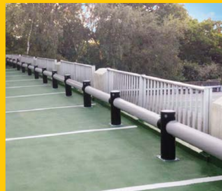
Zábrana iFlex Single Traffic Barrier vysoká tvoří obvodovou ochranu víceúrovňového parkoviště.
