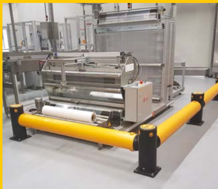
iFlex Single Traffic Barrier chrání stroje v balárně.
