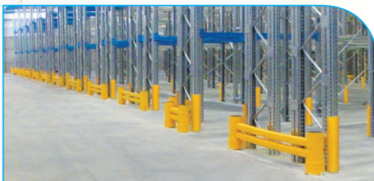
Instalace v novém skladu – (Izrael)
